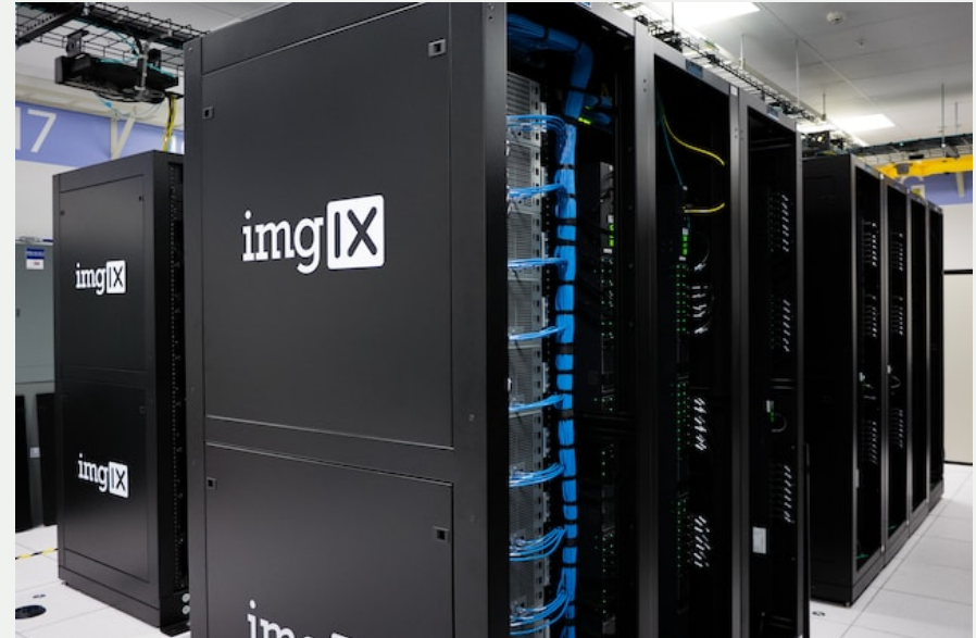
Des baies dans un data center, source : imgix, unsplash
