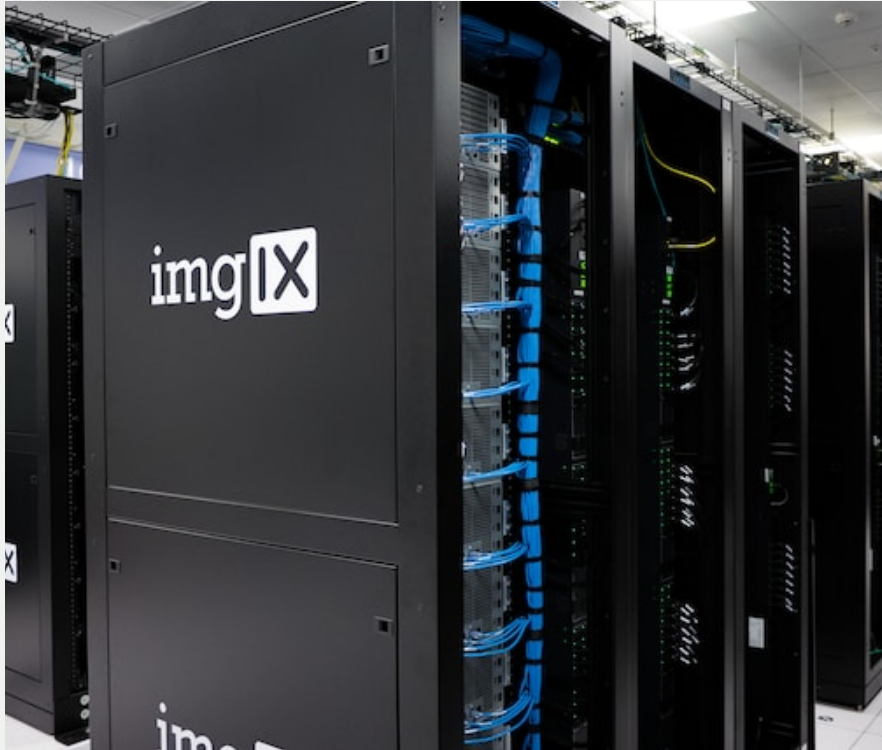
Des baies dans un data center, source : Imgix, unsplash
